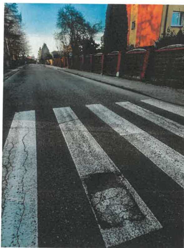
Załącznik nr 1 – ubytki w nawierzchni na ul. Polnej
